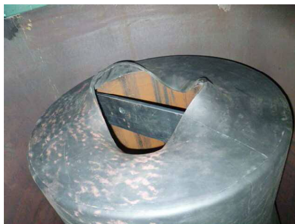
写真-2 杭天端挿入不可状態
