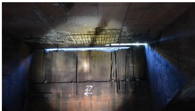
写真-1 栈橋劣化状況
