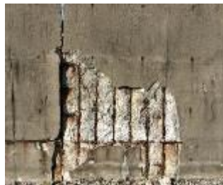
写真-3 劣化した壁構造物
