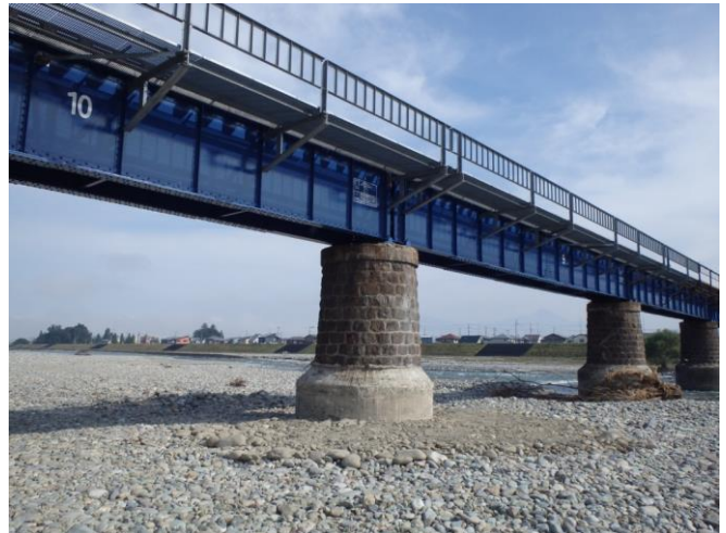
写真 1 被災橋りょうの全景
