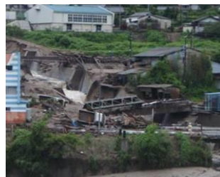
図2 流失した下り線桁
