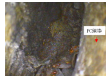
図-5 PC 横締鋼棒腐食状況調査結果(空隙内部)
