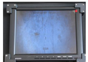
(b) 調査面のひび割れ
