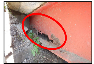
写真 2 桁端部の板厚減
