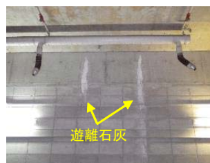
写真-1 地下部の損傷
