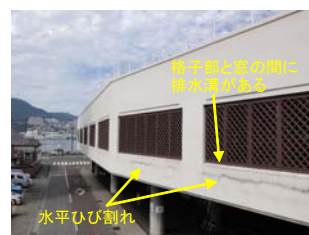
外壁窓部の水平ひび割れ
