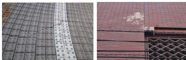
写真-4 路面タイルの損傷 写真-5 壁面タイルの損傷
