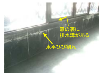
外壁窓部の水平ひび割れ
