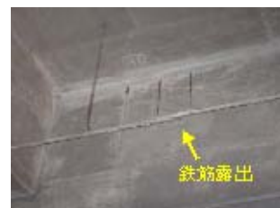
写真-2 地上部の損傷
