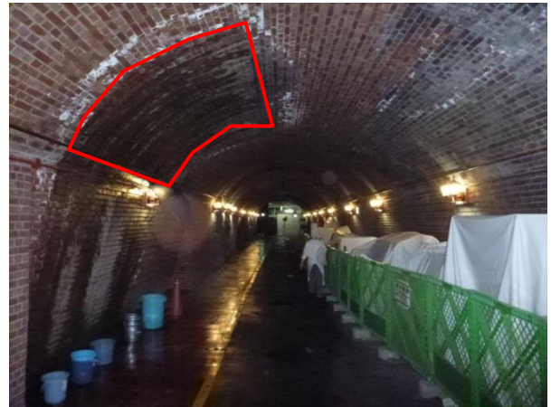
写真-1 漏水箇所の状況
