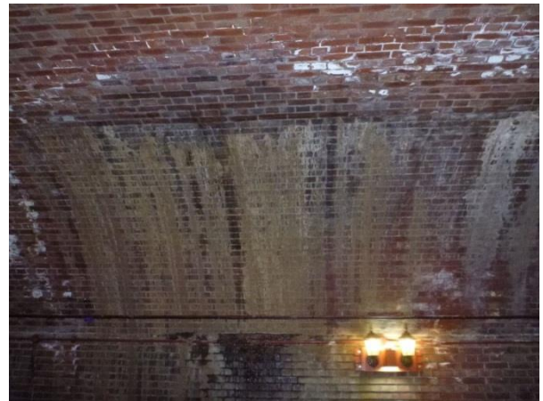
写真-2 漏水状況
