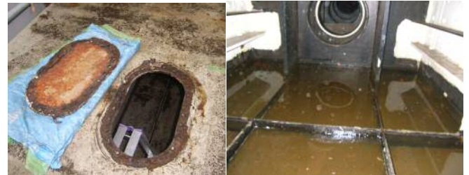
写真-1 鋼製橋脚のマンホール部損傷事例
