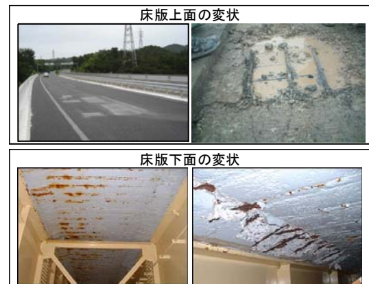
図-2 床版の変状状況
