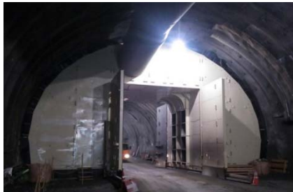
図-4 移動式一体型防音扉全景
