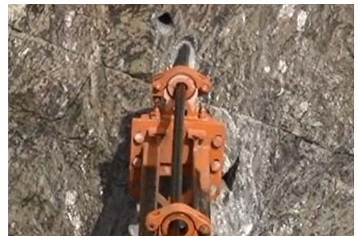
写真-1 ロッドの変形状況（予備穿孔試験）
