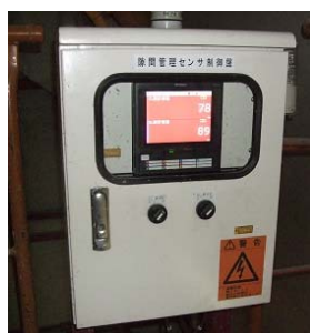
写真-2 コンラップ監視システム制御盤全景
