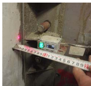
写真-1 コンラップ監視システム レーザー変位計設置状況
