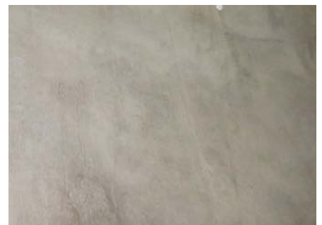
写真-1 覆工コンクリートの出来栄
