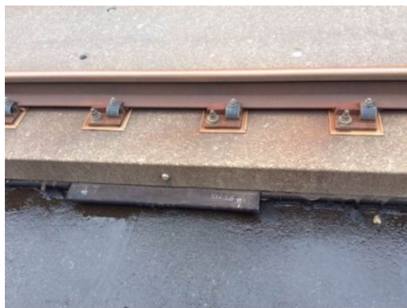
写真1 スラブマットずれ
