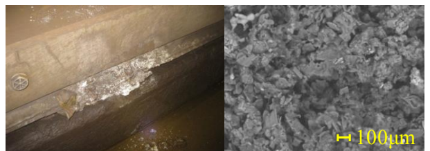
写真-3 析出箇所の状況 写真-4 表面の拡大
