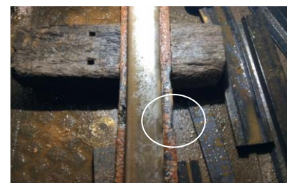
写真-3 締結装置部 3mm の腐食
