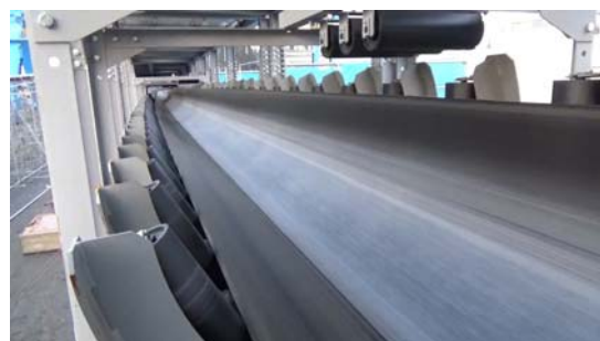
写真-5 700R 区間 無負荷運転時
