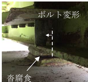
図-9 沓腐食状況
