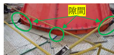
(a) 煙突と足場板の隙間
