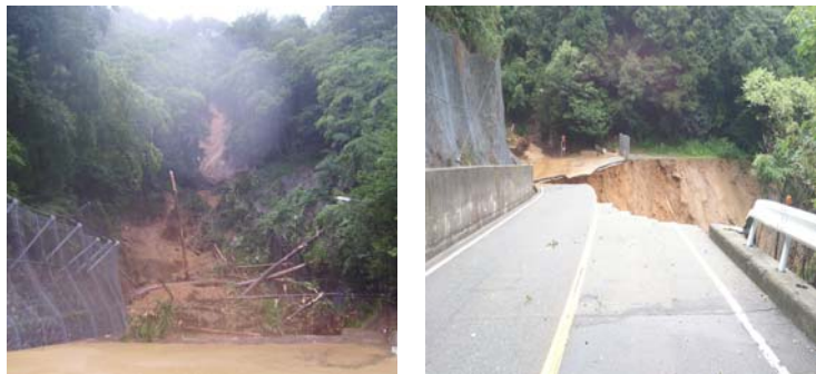
写真-1 T N上部崩落状況 写真-2 本線盛土崩落状況
