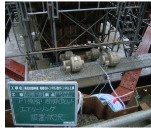
写真-1 送風設備設置状況
