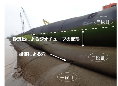
写真-5 ジオチューブの損傷と変形
