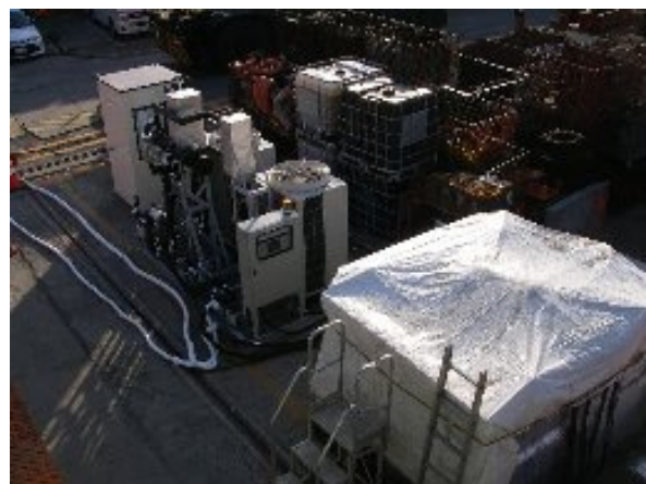
図3 冷凍機運転状況
