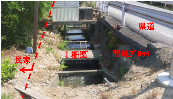
写真－1 改修前の水路（下流から上流を臨む）
