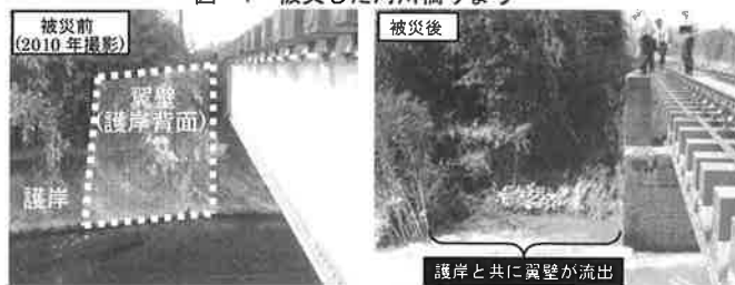
図 - 2 被災 1 翼壁流出状況
