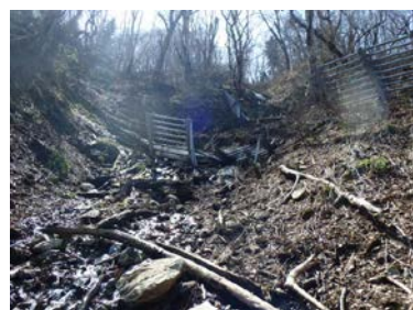
写真2 被災後の状況
