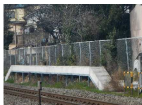
写真-2 送電線トラフ
