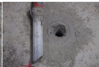
図-6 ボルトと樹脂が剥離
