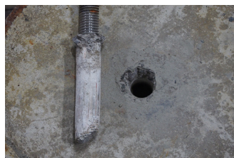
図-5 樹脂と母材が剥離
