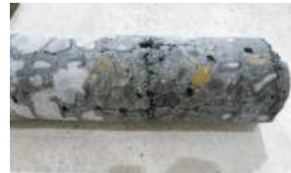
写真-4 テーパ型ナット周辺のひび割れ状 (φ 32)
