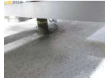
写真-3 PC 鋼棒 φ 32 破断時のコンクリート上面 の状況
