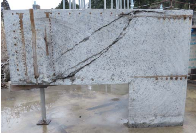
写真-4 梁中央のひび割れ状況 (2-T)
