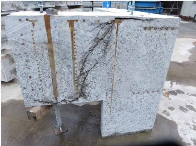
写真-3 梁中央のひび割れ状況 (1-T)
