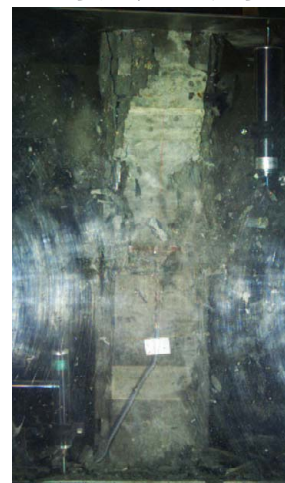
図6 柱の爆裂状況
