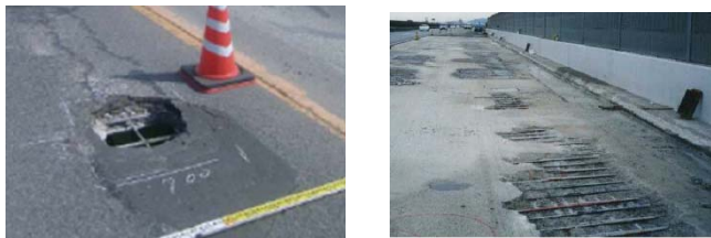
写真-1 床版土砂化・抜け落ち事例 1)
