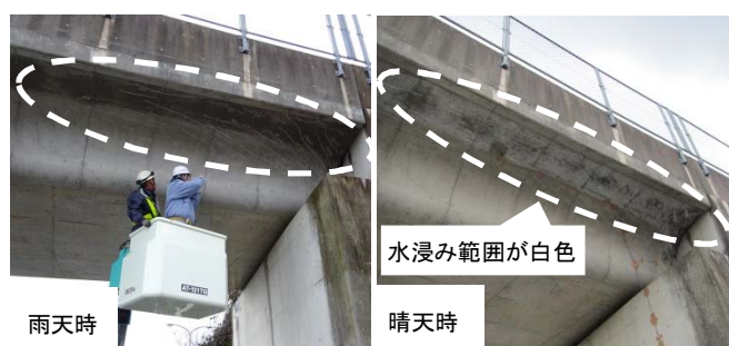
写真-1 現地踏査状況(破線:ひび割れ+水浸み位置)
