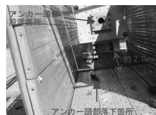
図-5 アンカー頭部の飛出した軌跡
