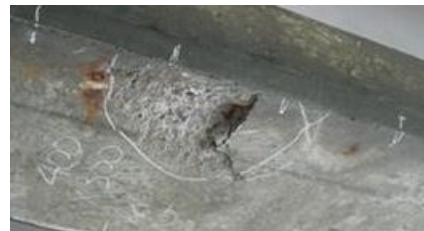
図-1 G3桁のコンクリート剥落
