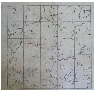
写真-2 普通コンの加熱後の状況
