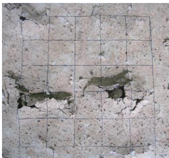
写真-1 PP コンの加熱後の状況
