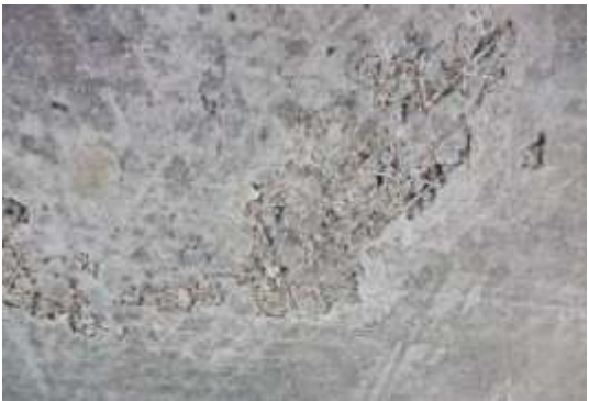
写真-2 メッシュ施工箇所における コンクリート未充填の一例
