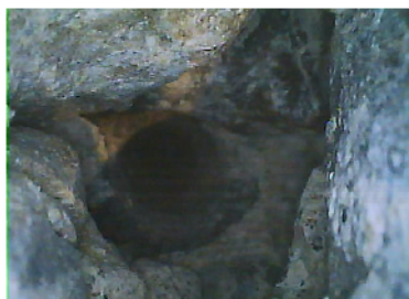
写真-2 豆板内部状態（表面付近）
