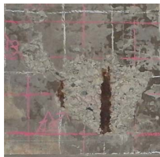
写真-1 豆板の表面状態
