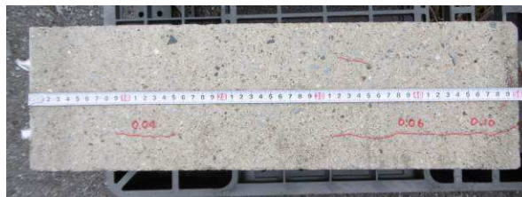
図-2 Rのひび割れ状況
