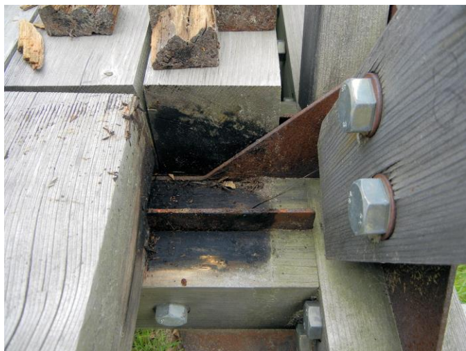
写真-1 横梁上面の変色
