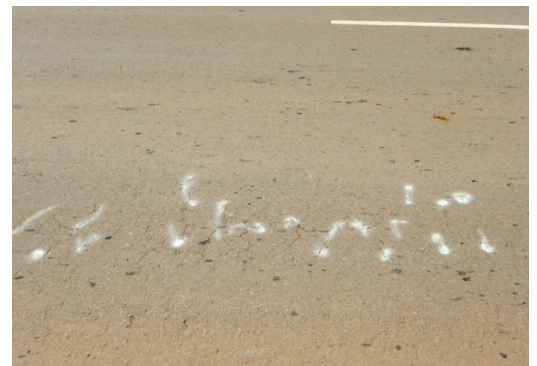
写真－1 発生したヘアクラックの様子
