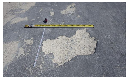
写真 2 現地道路舗装損傷状況
