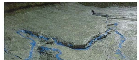
写真-1 インバート吹付の変状
