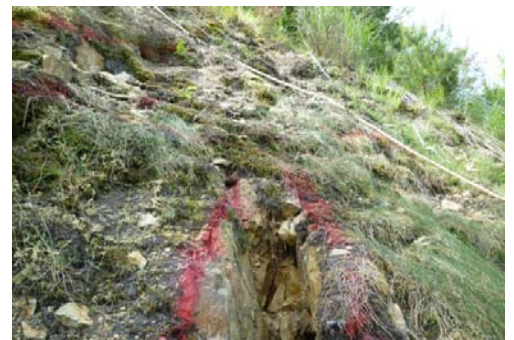
図 2 第 4 のり面変状箇所
