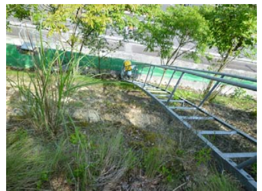
図 3 点検はしご変形状況
