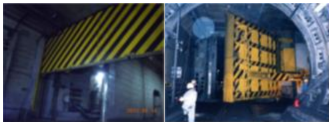
写真-1 機械式防水ゲート 写真-2 スイングゲート
