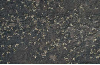
写真－2 水路トンネル壁面の水虫付着状況
