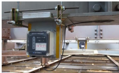
図-1 鋼橋監視装置
