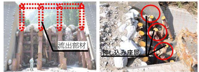
(a) 正面図 (b) 水平部材圧縮状況 写真-1 梨子沢第一砂防堰堤被災状況
